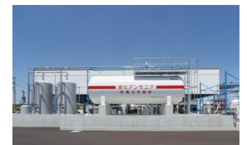
津工場アンモニア設備
